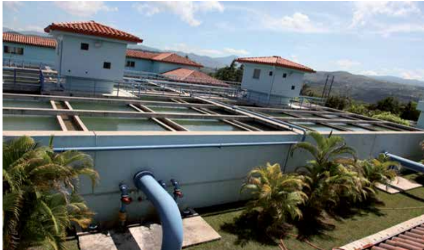
Planta potabilizadora de agua: La Concepción, Tegucigalpa, Honduras
