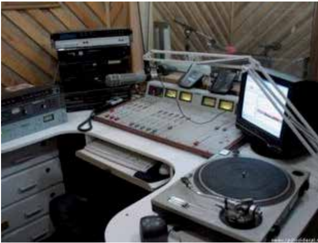
Cabina de Radio
