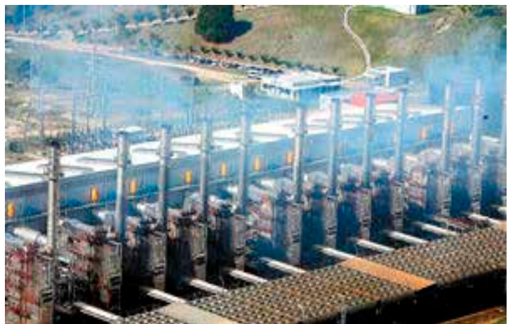
Planta térmica. Generación de energía eléctrica por medio de bunker.
