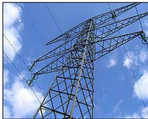
Línea de alta tensión.
